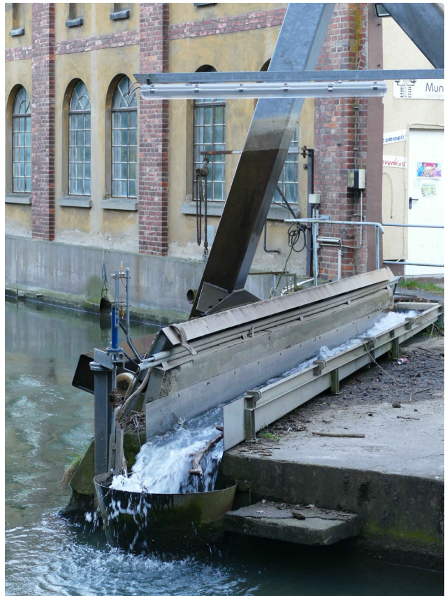
Der Rechen der Turbinenanlage (Foto: Martin Stöber, 2019)
